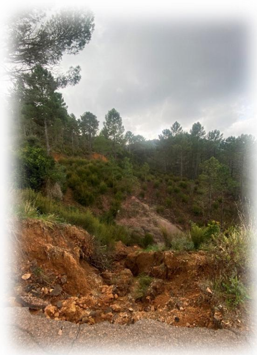
Effondrement de la piste DFCI H32 Cap Roux (ex H34 Plateau d'Anthéor) - Commune de Saint-Raphaël
