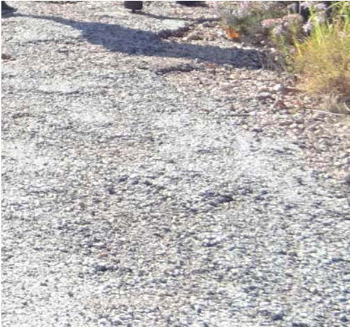
Dégradation de chaussée
