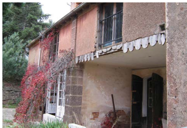
Maison Forestière du Malpey - en dégradation progressive
