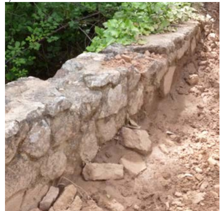
Patrimoine vernaculaire en dégradation
