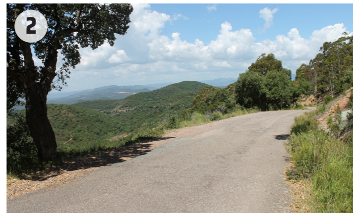
Accotement dangereux, - d'espace, + très impactant visuellement
