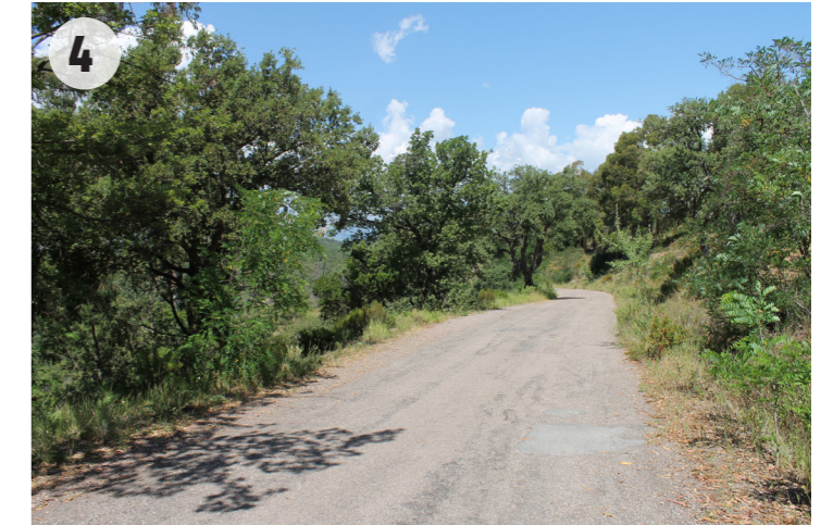
Accotement restreint, dangereux et très impactant sur le milieu
