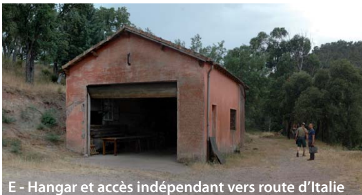
.... et talus en contre-bas
