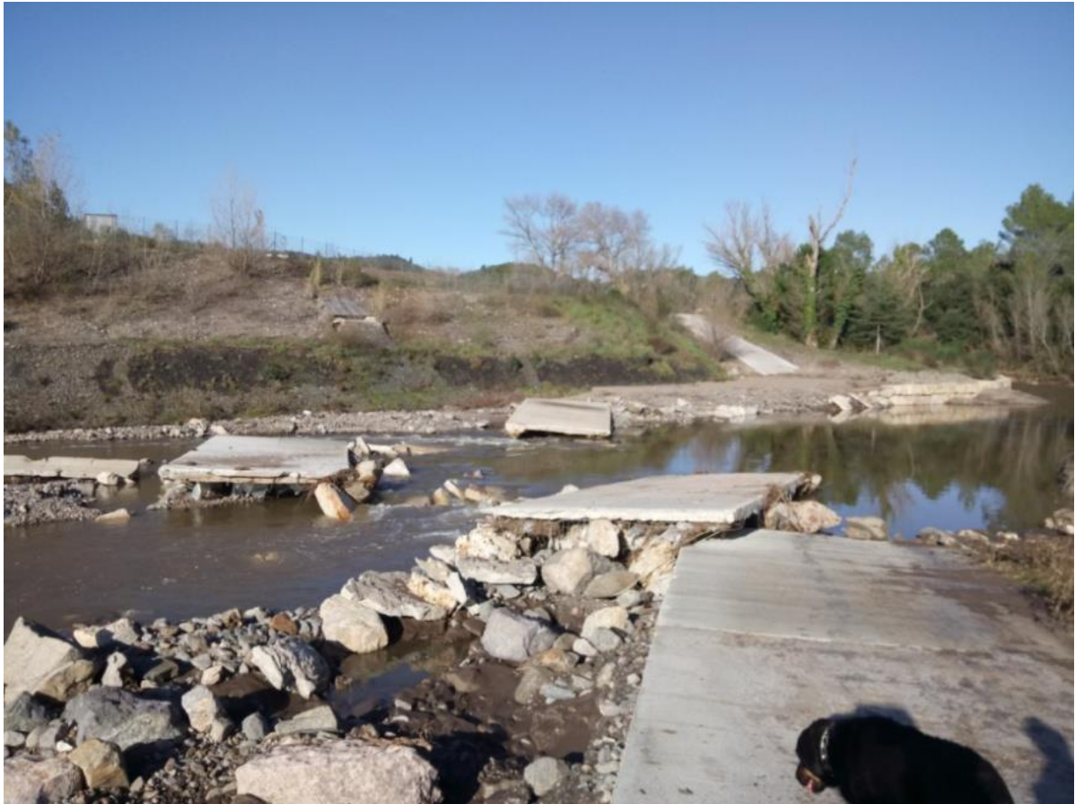
Gué du Reyran à Malpasset à près la crue du 1 er décembre 2019
