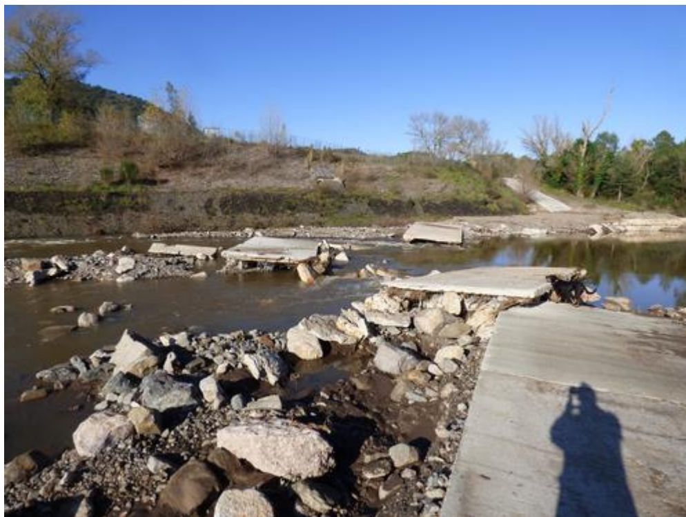
Gué du Reyran après les violentes pluies du 1 er décembre 2019
