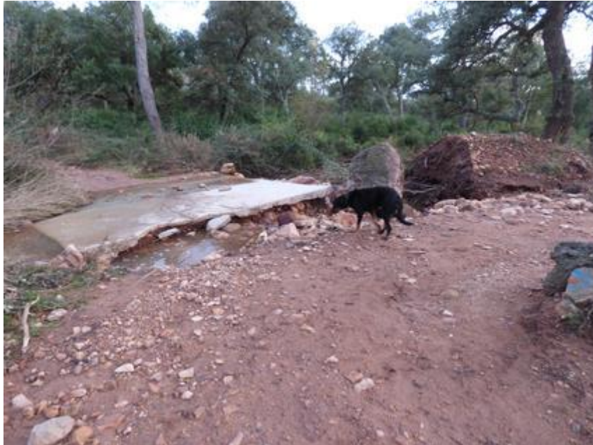
Piste des Lauriers G 57 : destruction du radier du ravin des Lauriers
