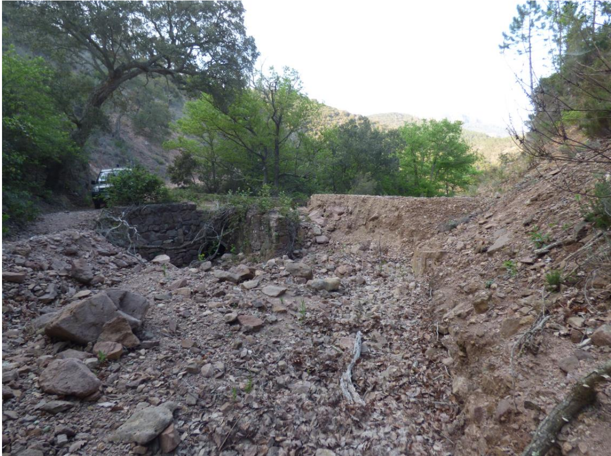
Piste DFCI H 23 des Charretiers : avaloir et buse avant travaux
