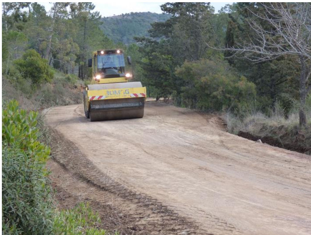
Compactage par la Régie du Département de la Piste DFCI H 48 de l'Avellan à Fréjus
